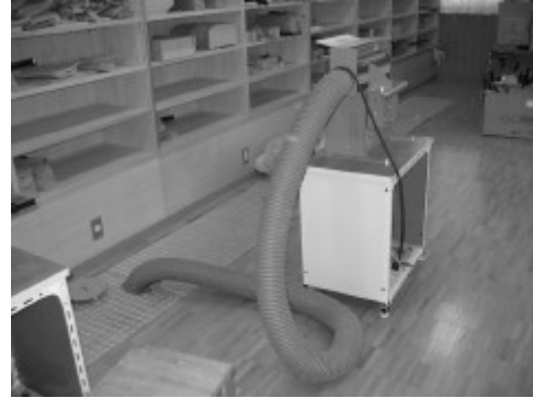
写真 13 集塵設備と機械を接続するホース
