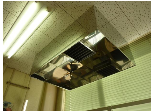
写真 - 7 天井ダクト
